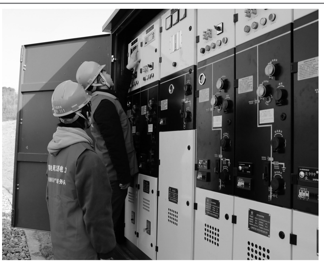
冬季寒冷天气容易给电力线路带来外部影响，造成各种安全隐患，连日来，国网萍乡市芦溪县供电公司宣风供电所加强巡线工作，全力保障冬季正常供电。图为工作人员在赣西野生动物园支线对园区内环网柜进行巡视和检查。(黎龙娇 摄)
